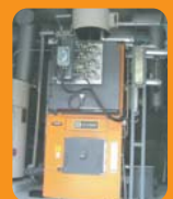
ペレットボイラー
